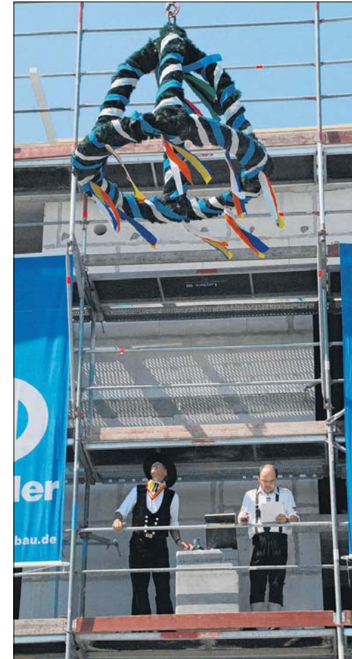
Auf dem Baugerüst und unter der Richtkrone verlas Zimmermann Burkhard Ries den gereimten Richtspruch. Fotos: Reum
